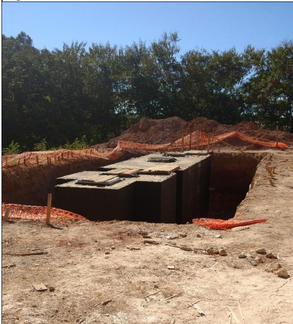
Tanque para reaproveitamento de águas pluviais para a irrigação com capacidade de 40.000 litros.
