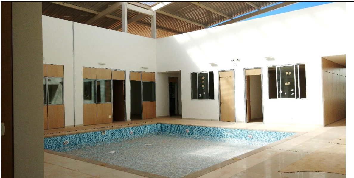
Espelho d'água com o objetivo de aumentar a umidade relativa do ar e oferecer sensação térmica mais agradável.
