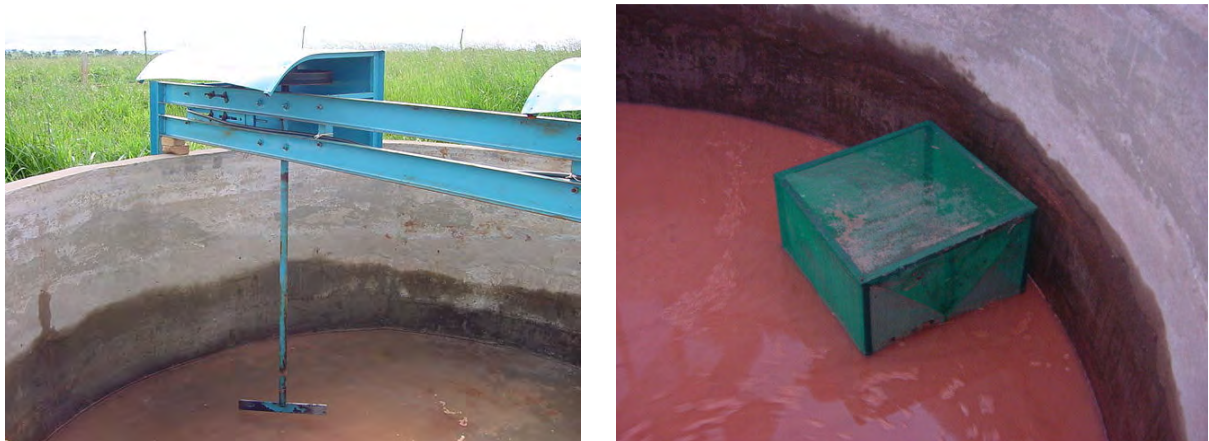
FIGURA 23 – Detalhe do misturador e da proteção da sucção da bomba de fertirrigação, instalada para evitar entupimento dos rotores dessa bomba.
