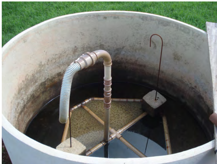
FIGURA 25E: Tubulação de PVC de 50 mm perfurada, com registro de esfera, mangote de acoplamento para turbina e pesos de concreto nas laterais.
