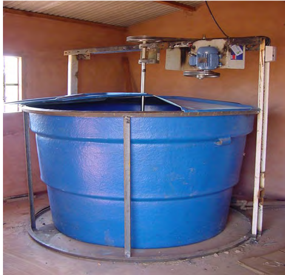
FIGURA 25A – Caixa de fertirrigação instalada diretamente na sucção da bomba de irrigação (injeção direta).
